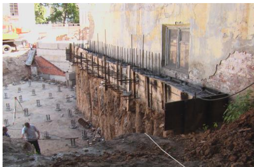
Рисунок 3. Подпорная стена из двух рядов буроинъекционных свай ЭРТ (РИТ, ФОРСТ, ЭРСТ) как ограждение котлована в г. Н. Новгород.
