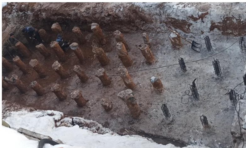
Рисунок 2. Свайное поле под монолитный железобетонный контрфорс: 1 - оголовки буронаблюдательных свай ЭРТ; 2 - бетонная подготовка под ростверк
