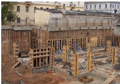
Рисунок 4. Ограждение котлована из буроинъекционных свай ЭРТ (РИТ, ФОРСТ, ЭРСТ) в г. Н. Новгород.
