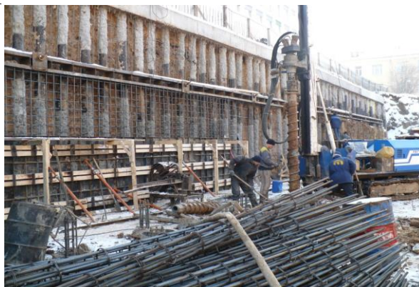
Рисунок 5. Ограждение котлована из буроинъекционных свай ЭРТ (РИТ, ФОРСТ, ЭРСТ) и грунтовых анкеров ЭРТ в г. Н. Новгород.
