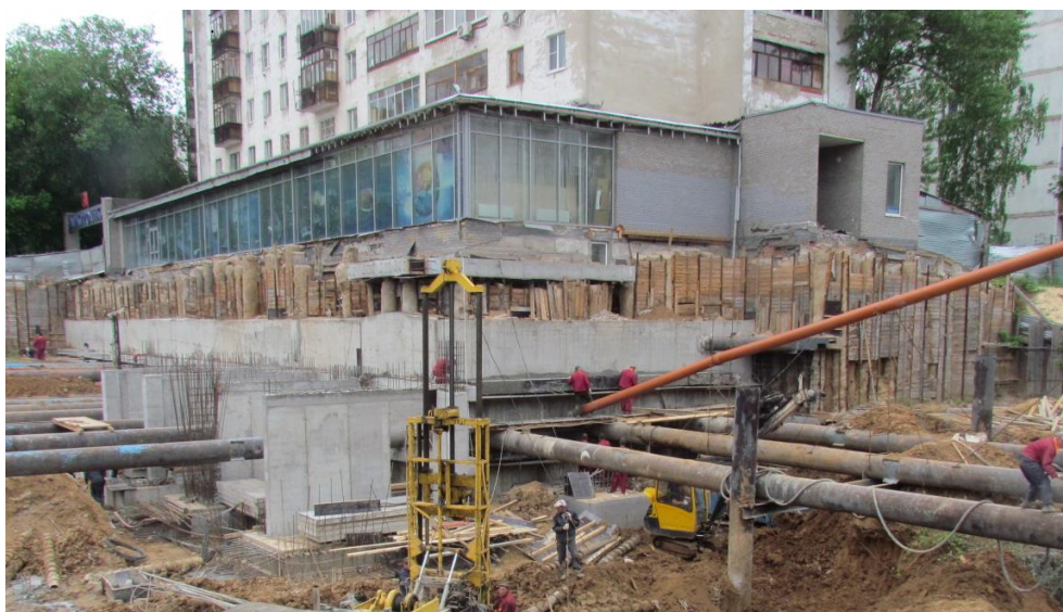
Рисунок 1. Схема закрепления подпорных стен котлована расстрелами из стальных труб 1000 мм: 1- существующие буронабивные сваи ограждения котлована; 2-ограждение котлована из монолитного железобетона; 3-моно-итные железобетонные контрфорсы усиления существующей подпорной стены; 4- монолитный железобетонный ростверк; 5-существующие трубы - расстрелы усиления подпорных стен
