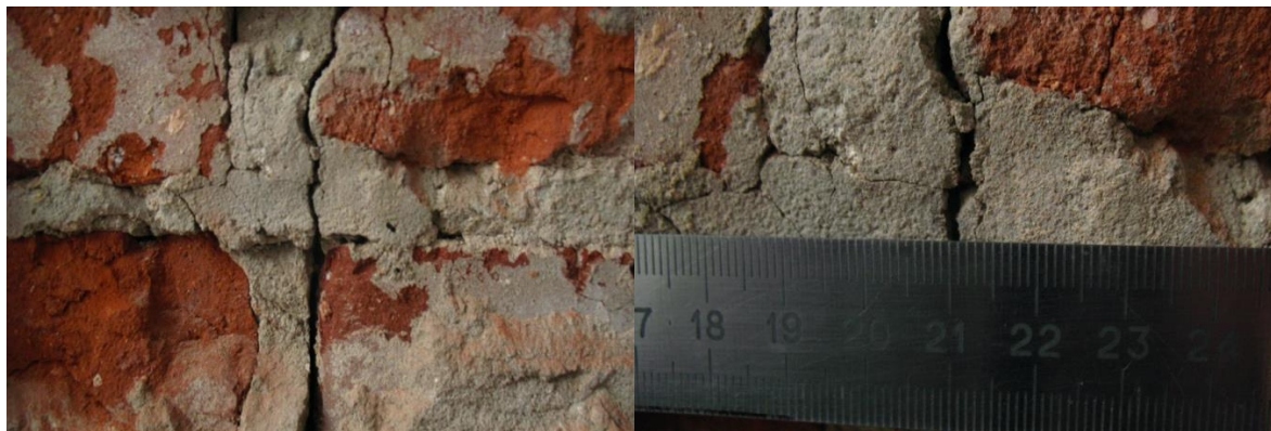
Рисунок 6– Вертикальная трещина в кирпичной кладке наружной стены. Ось 19, между осями Б-В
