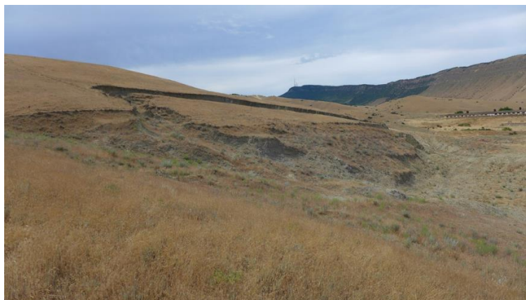
Рисунок 1. Блоковый техногенный оползень (общий вид), май 2020 г.
