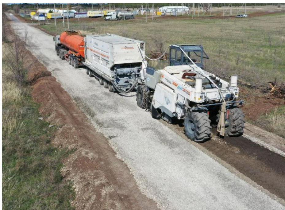
Рисунок 2. Укладка холодной органоминеральной смеси с применением комплекса машин на автомобильной дороге «Урал-Муханово»-Садгород-Чернигово-Марково.
