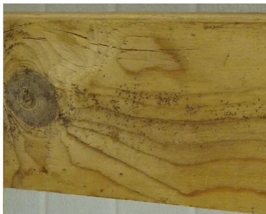
Рисунок 1. Трещины в наружных слоях шпона LVL бруса.
