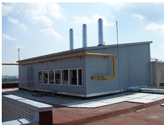
Рисунок 1. Модульная котельная на крыше.
