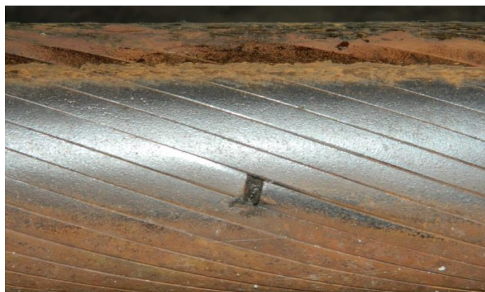
Рис. 1 Обрыв проволоки наружного слоя
