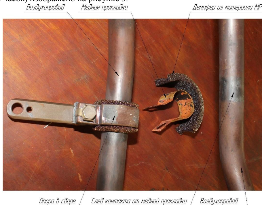
Рисунок 3 – Внешнее состояние воздухопроводов и демпферов
