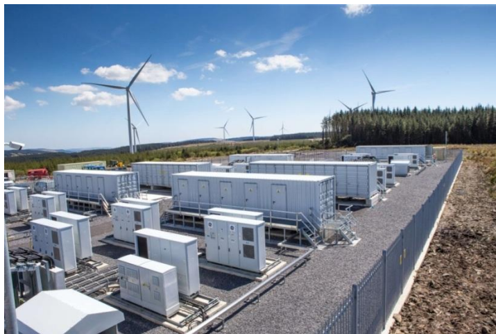
Рисунок 2. Трансформаторные подстанции (накопители энергии)
