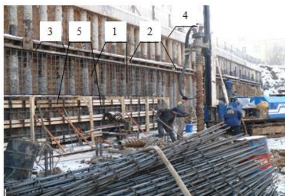
Рисунок 5. Ограждение котлована из буроналивных свай ЭРТ (РИТ, ФОРСТ, ЭРСТ) и грунтовых анкеров ЭРТ в г. Н. Новгород: 1 – ограждение котлована из буроналивных свай ЭРТ (РИТ, ФОРСТ, ЭРСТ); 2 – грунтовые анкера ЭРТ; 3 – анкерный пояс; 4 – монолитный железобетонный обвязочный пояс; 5 – опалубка.
