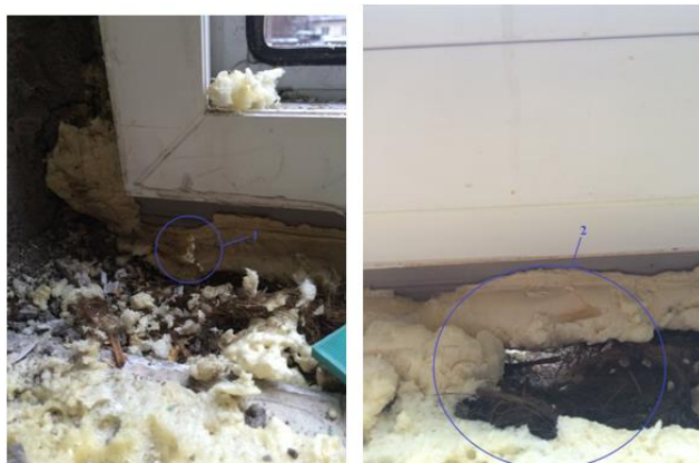
Рисунок 1. Примеры нарушений технологий монтажа оконных блоков: 1, 2 – отсутствие монтажной пены.
