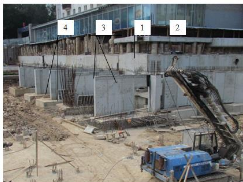
Рисунок 2. Монолитные железобетонные контрфорсы на буроинъекционных сваях ЭРТ (РИТ, ФОРСТ, ЭРСТ) как упор деформированной подпорной стены в г. Н. Новгород: 1 – существующая монолитная железобетонная подпорная стена как упор деформированного ограждения котлована из буронабивных свай 2; 3 – монолитные железобетонные контрфорсы по монолитным железобетонным ростверкам 4.
