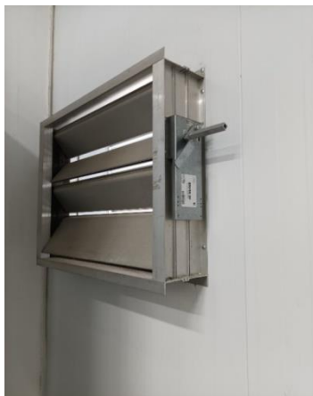
Рисунок 1. Металлические задвижки в модульной котельной.
