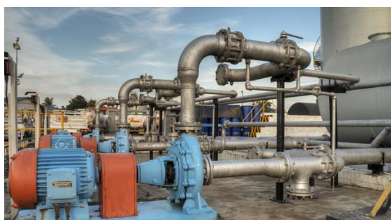
Рисунок 1. Промышленные насосные станции.
