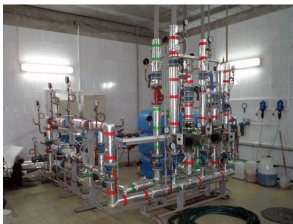
Рисунок 1. Индивидуальный тепловой пункт (ИТП).
