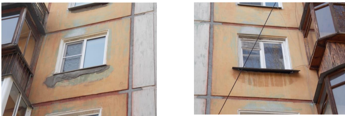
Рисунок 2. Отслоение ремонтной области (а) и водонасыщение и разрушение подоконной зоны (активная стадия) (б).
