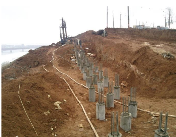
Ленточное свайное поле из буронабивных свай ЭРТ (РИТ, ФОРСТ, ЭРСТ) под монолитную уголковую подпорную стену на Окском съезде в г. Н. Новгород
