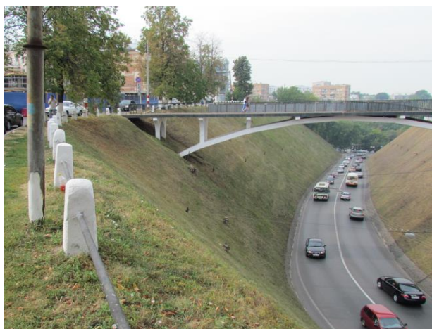
Склон вдоль улицы Пожарской в г. Н. Новгород
