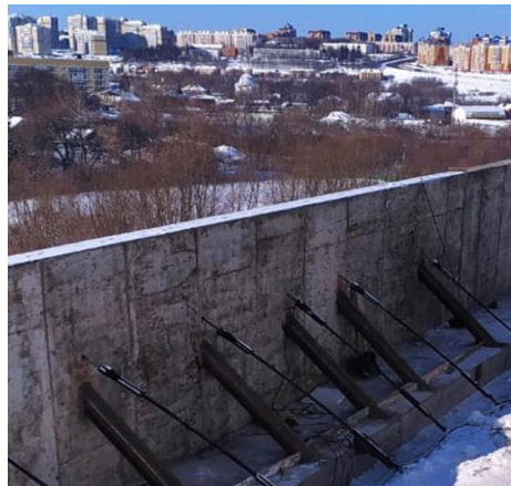
Рисунок 3. Заглубленные удерживающие железобетонные конструкции с использованием буроинъекционных свай ЭРТ (РИТ, ФОРСТ, ЭРСТ), грунтовых анкеров ЭРТ и монолитных железобетонных угловых подпорных стен в г. Чебоксары.
