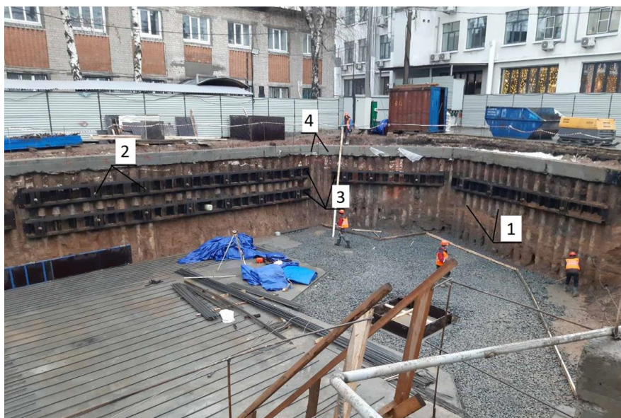
Рисунок 6б. Фрагмент плана ограждения котлована: 1-бурионъекционные сваи ЭРТ; 2-грунтовые анкера ЭРТ; 3-анкерный обвязочный пояс; 4-монолитный железобетонный обвязочный пояс.
