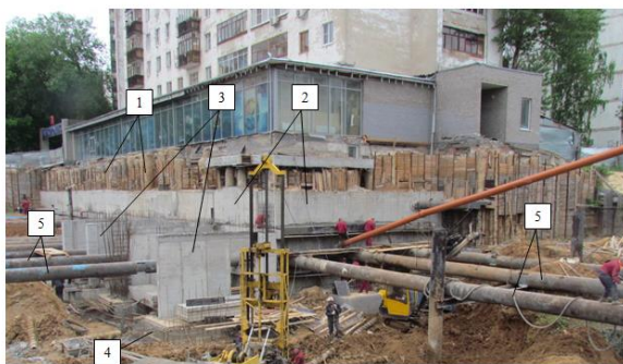
Рисунок 1. Схема закрепления подпорных стен котлована расстрелами из стальных труб 1000 мм: 1 - существующие буронабивные сваи ограждения котлована; 2 - ограждение котлована из монолитного железобетона; 3 - монолитные железобетонные контрфорсы усиления существующей подпорной стены; 4 - монолитный железобетонный ростверк; 5 - существующие трубы - расстрелы усиления подпорных стен.
