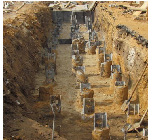
Ленточное свайное поле из буроинъекционных свай ЭРТ (РИТ, ФОРСТ, ЭРСТ) вдоль улицы Пожарской в г. Нижний Новгород
