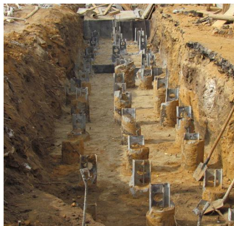
Ленточное свайное поле из буронабивных свай ЭРТ (РИТ, ФОРСТ, ЭРСТ) вдоль улицы Пожарской в г. Нижний Новгород
