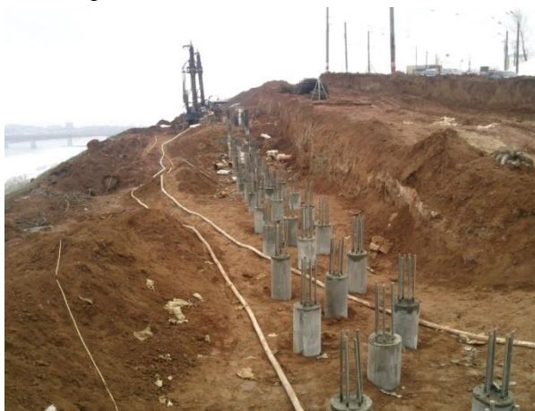
Ленточное свайное поле из буронабивных свай ЭРТ (РИТ, ФОРСТ, ЭРСТ) под монолитную угловую подпорную стену на Окском съезде в г. Н. Новгород
