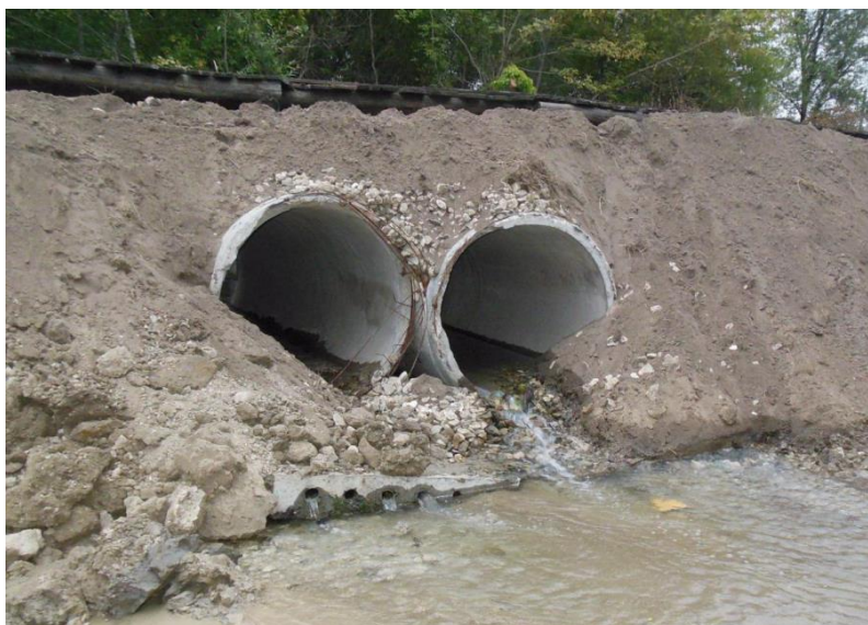
Рисунок 2. Разрушение узла сопряжения ВПТ и насыпи при отсутствии оголовка.
