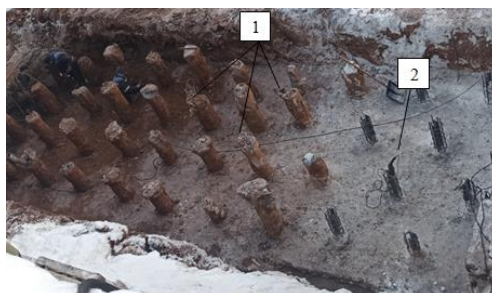
Рисунок 2. Свайное поле под монолитный железобетонный контрфорс: 1 – оголовки буроинъекционных свай ЭРТ; 2 – бетонная подготовка под ростверк.
