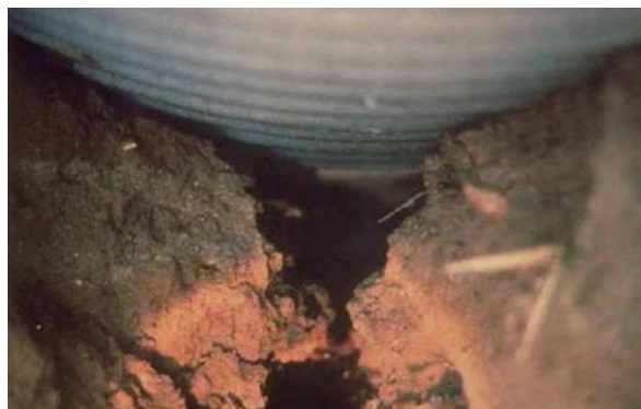
Рисунок 5. Вымывание грунта из грунтового конверта
