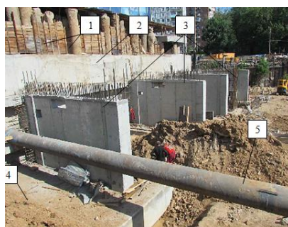
Рисунок 3. Фрагменты выполненных монолитных железобетонных контрфорсов: 1 – существующие буронабивные сваи ограждения котлована; 2 – ограждение котлована из монолитного железобетона; 3 – монолитные железобетонные контрфорсы усиления существующей подпорной стены; 4 – монолитный железобетонный ростверк; 5 – существующая труба – расстрел усиления
