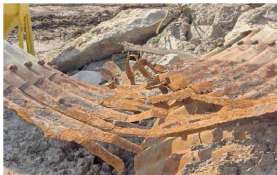
Рисунок 6. Сквозные повреждения лотковой части, вследствие абразивного износа
