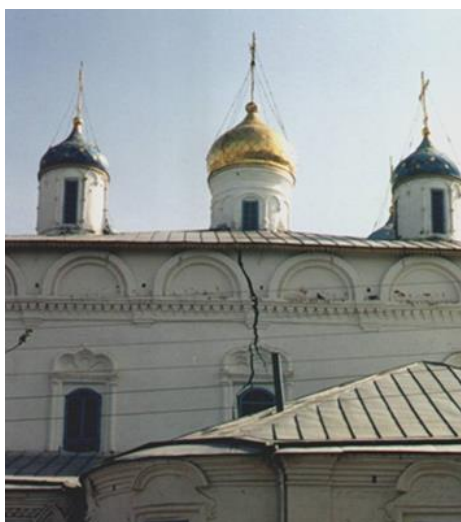
Рисунок 1. Трещина над оконным проемом храма (северный фасад).
