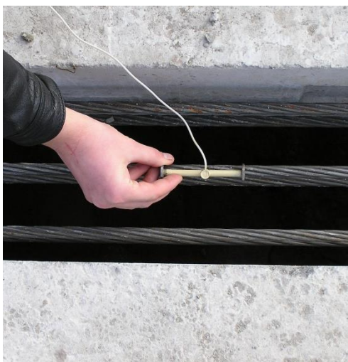
Рисунок 2. Деформометр, закладываемый до бетонирования монолитного «ригеля».
