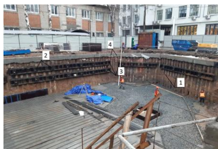
Рисунок бб. Фрагмент плана ограждения котлована: 1 - буринъекционные сваи ЭРТ; 2 - грунтовые анкера ЭРТ; 3 - анкерный обвязочный пояс; 4 - монолитный железобетонный обвязочный пояс
