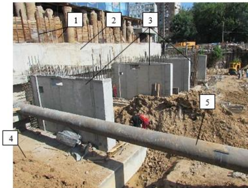
Рисунок 3. Фрагменты выполненных монолитных железобетонных контрфорсов: 1 - существующие буронабивные сваи ограждения котлована; 2 - ограждение котлована из монолитного железобетона; 3 - монолитные железобетонные контрфорсы усиления существующей подпорной стены; 4 - монолитный железобетонный ростверк; 5- существующая труба - расстрел усиления.
