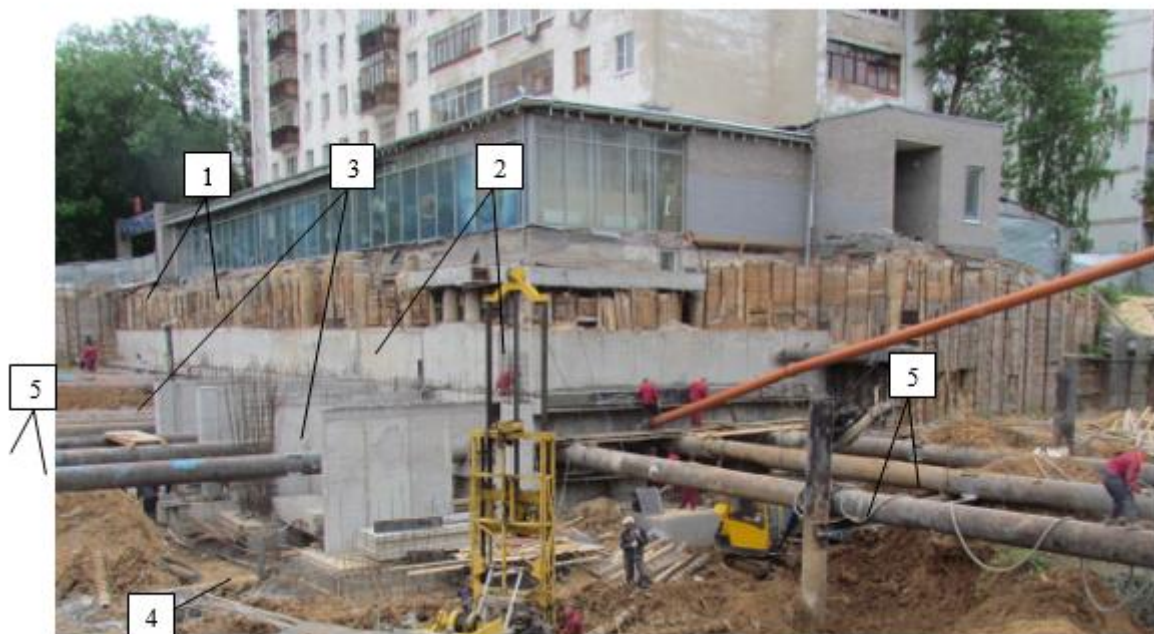
Рисунок 1. Схема закрепления подпорных стен котлована расстрелами из стальных труб 1000 мм: 1 – существующие буронабивные сваи ограждения котлована; 2 – ограждение котлована из монолитного железобетона; 3 – монолитные железобетонные контрфорсы усиления существующей подпорной стены; 4 – монолитный железобетонный ростверк; 5 – существующие трубы – расстрелы усиления подпорных стен.
