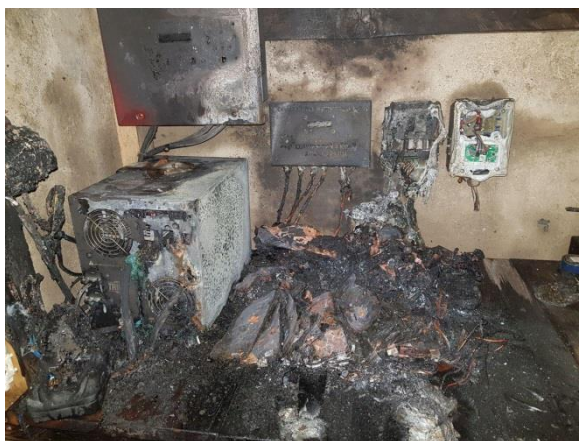
Рисунок 2. Сгоревшее оборудование вследствие перегрева Li-ион батареи.
